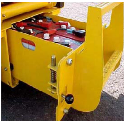
Рисунок 21. Секция аккумуляторных батарей.
